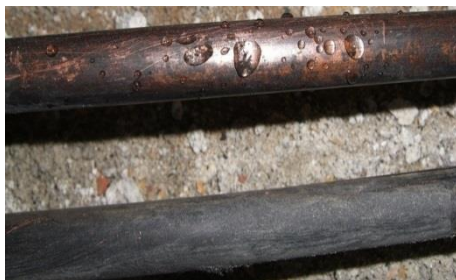
Beschädigte hydraulische Leitung
